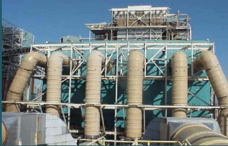
Conductos de FRP en una central energética.
