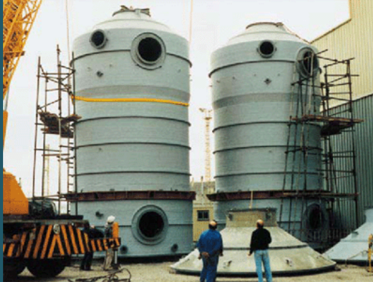
Electrofiltros húmedos en fundición de zinc hechos de resina epoxy vinilester en España.
