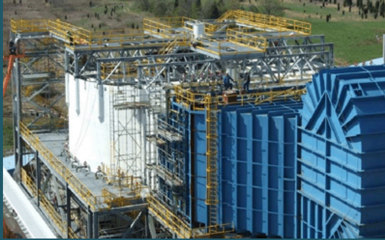
Depurador de gas de combustión de FRP completo (27 x 23,5 metros) con conducto de salida en central energética de 600 MW en el río Ohio.
