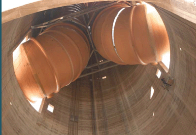
Forros internos de chimenea de FRP.
